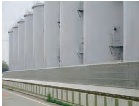
汚水タンクの下の漏れ防止の為の堰
